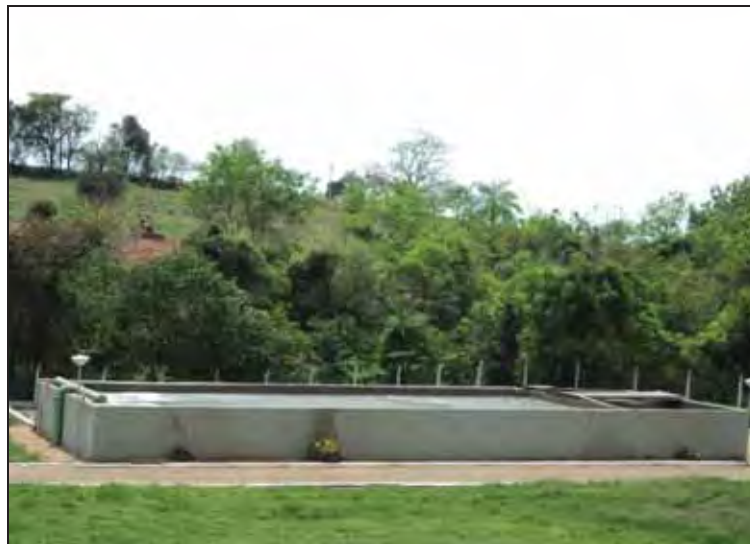
Figura 13: Decantador Secundário. Fonte: Ana Carla Zeni
