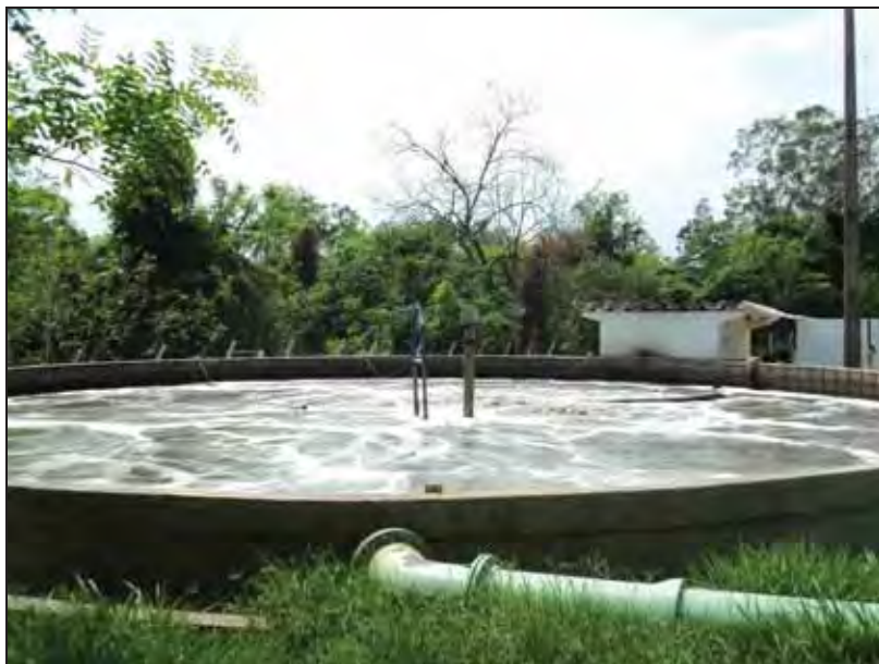
Figura 12: Tanque de aeração. Fonte: Ana Carla Zeni, ago/2012.
