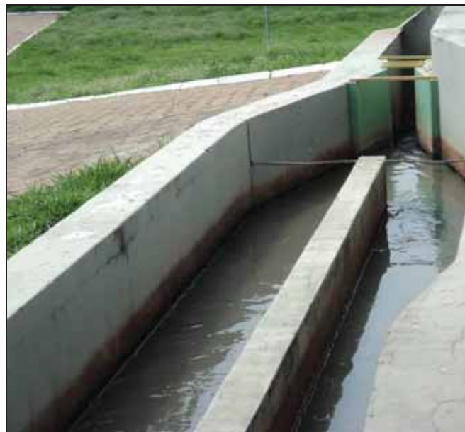
Figura 10: Calha Parshall. Fonte: Ana Carla Zeni, ago/2012.
