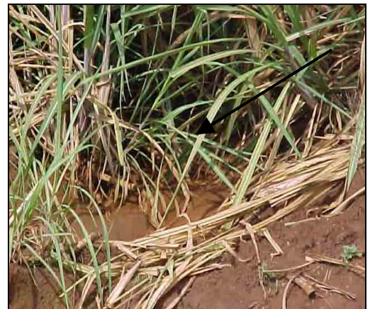
Foto 12. Detalhe do sulco erosivo
