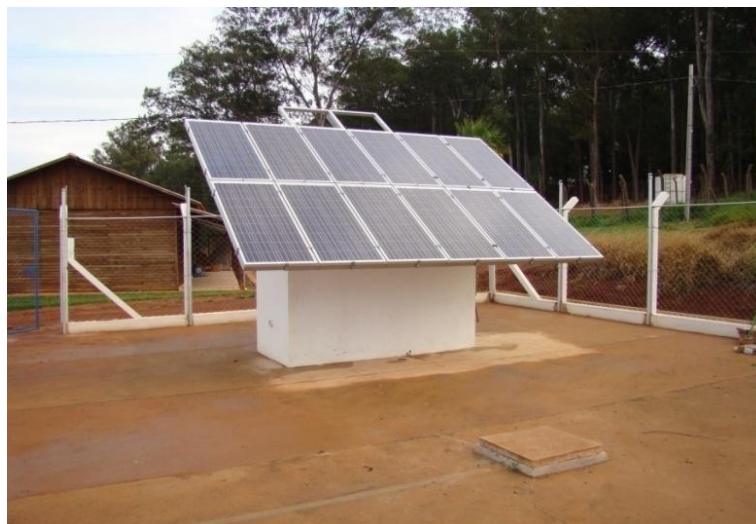
Figura 15. Arranjo fotovoltaico instalado na MGD-PV
