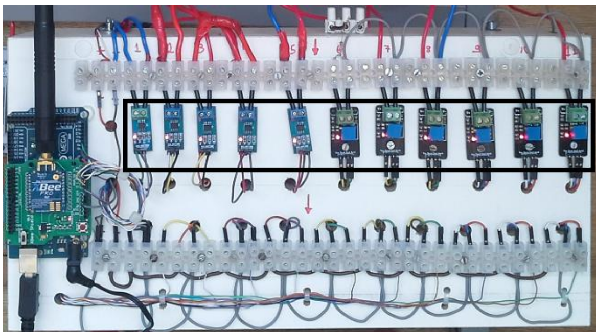
Figura 43: Sensores instalados no SFE
