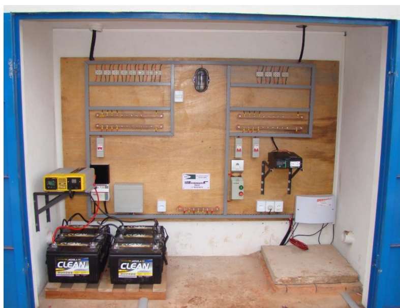
Figura 16. Equipamentos instalados na MGD-PV
