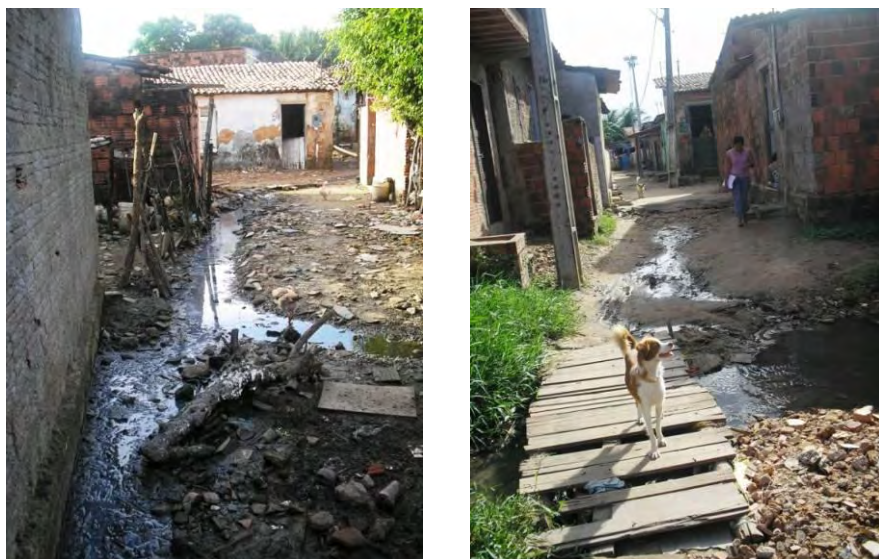
Figura 4.67 e 4.68 – Além da vulnerabilidade às inundações e a precariedade do saneamento, a comunidade Genibaú II convive com graves carências de acessibilidade, com uso de passagens e pontes improvisadas. Fonte: fotos do autor, junho de 2008.
