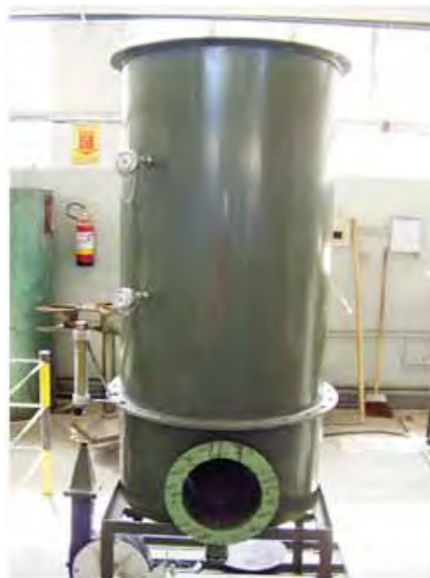
Fig 19: O gaseificador, vista geral.
