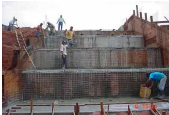
Dissipador de Energia no Cônego Rebouças Fonte: SEPLIN, 2012.
