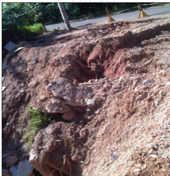
Figura 37. Deslizamento de encosta no bairro São Paulo.
