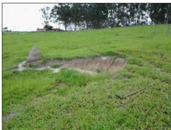
Figura 47. Abatimento de superfície e sulcos erosivos. Fonte: Laudimilla Leite.
