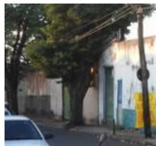
Figura 97 - Largura efetiva da calçada inadequada devido à obstrução permanente de vegetação
