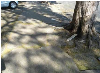
Figura 90 - Estado de conservação do piso da calçada
