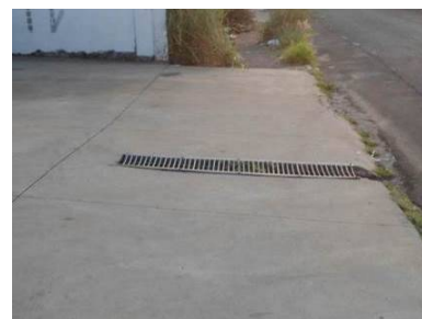
Figura 93 - Presença de grelha na faixa livre da calçada com vãos irregulares
