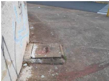
Figura 94 - Degrau na calçada
