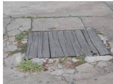
Figura 91 - Estado de conservação do piso da calçada
