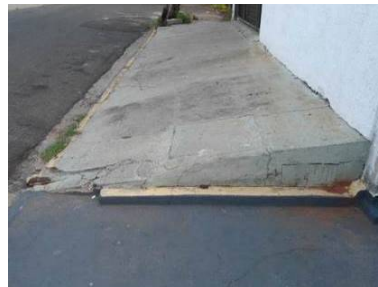
Figura 95 - Degrau na calçada
