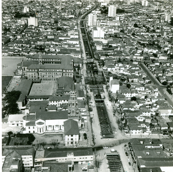
Figura 14 - Construção em VCA (vala a céu aberto) do primeiro trecho do METRÔ de São Paulo, da L1-Azul (1970)
