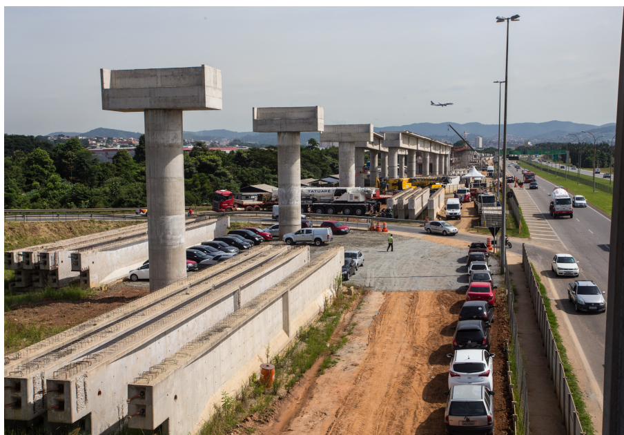
Figura 43 - Obras da L13-Jade às margens da Rodovia Hélio Smidt (SP-019), em Guarulhos (2016)
