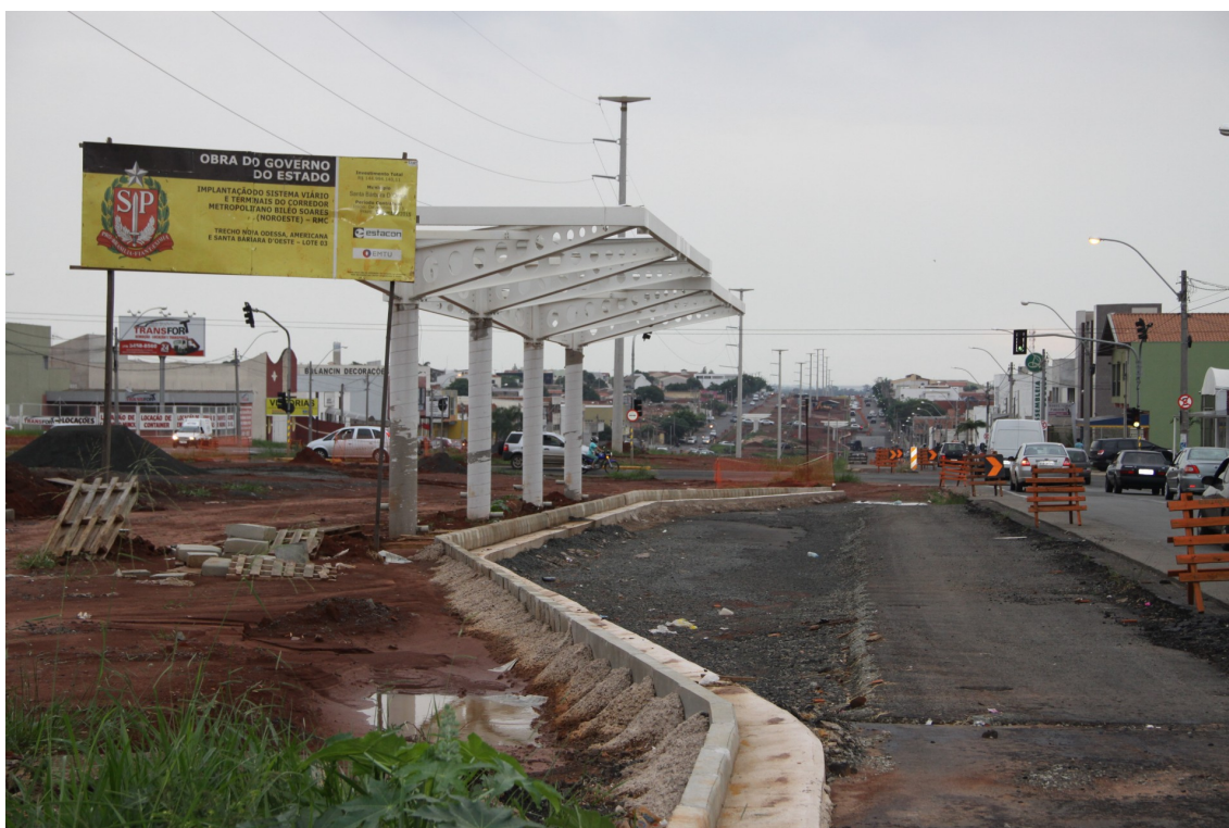
Figura 49 - Obras do Corredor Metropolitano Noroeste em Santa Bárbara d'Oeste, seguindo a diretriz das faixas non aedificandi do sistema elétrico regional (2015)
