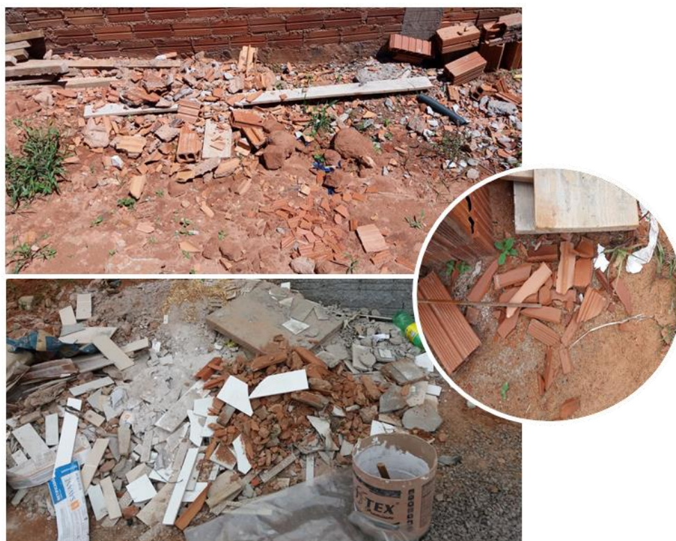
Figura 11. Resíduos dispostos em canteiro de obra residencial
