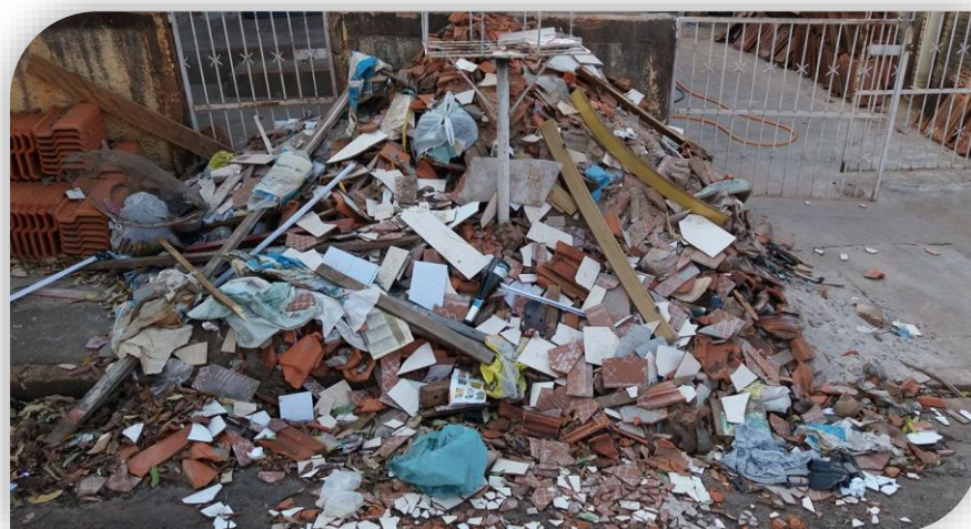
Figura 2. Disposição incorreta de RCD.
