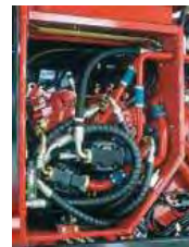
Um circuito com menos mangueiras facilita o acesso ao sistema hidráulico.
