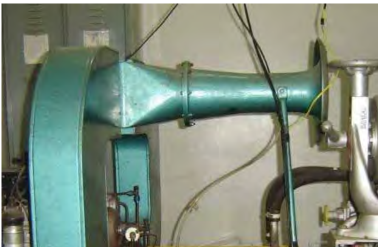
Figura 3.11 – Plenum para tomada de pressão estática na entrada do compressor.
