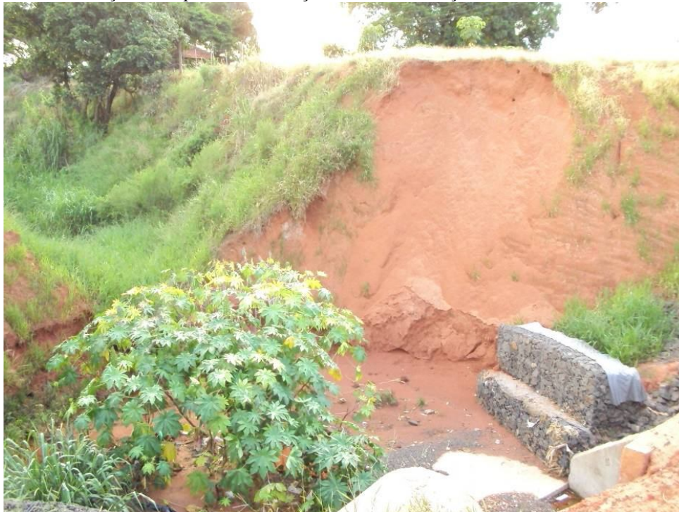
Foto 16 - Voçoroca depois da construção da Avenida Nações Norte.
