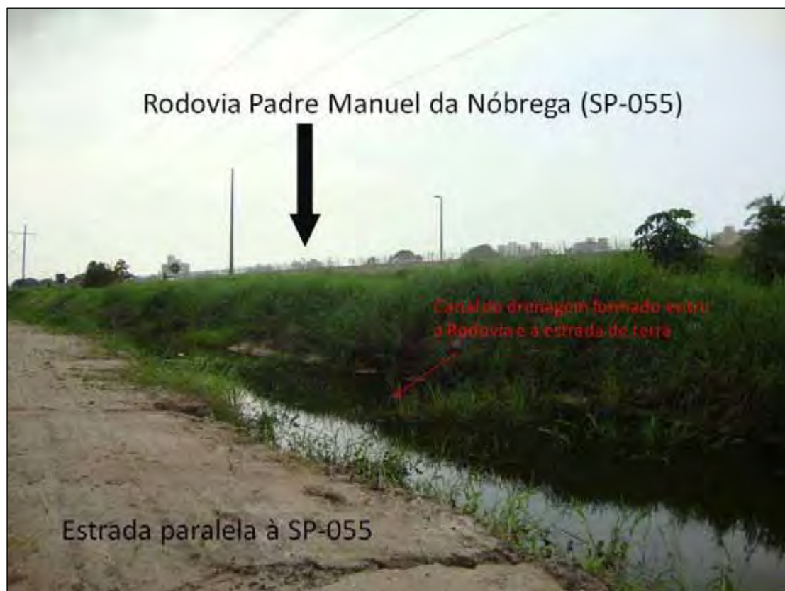
Figura 33: Exemplo de alteração do sistema de drenagem do município, com o surgimento de um canal de escoamento de águas pluviais entre a Rodovia SP-055 e uma estrada municipal não pavimentada, paralela à Rodovia, na Unidade Geoambiental Terraços Marinhos Urbanizados (Foto: Souza, 2010).
