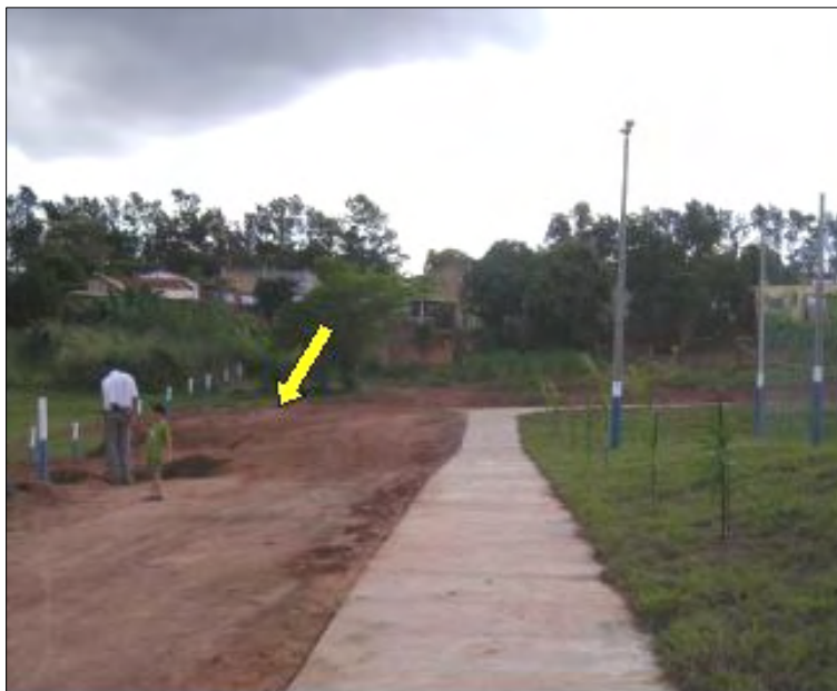
Figura 17 – A seta indica o avanço da erosão atrás da praça Sebastião Zanetti, bairro Jardim Santa Tereza. (Autora: LIMA, V. Jun/2005)
