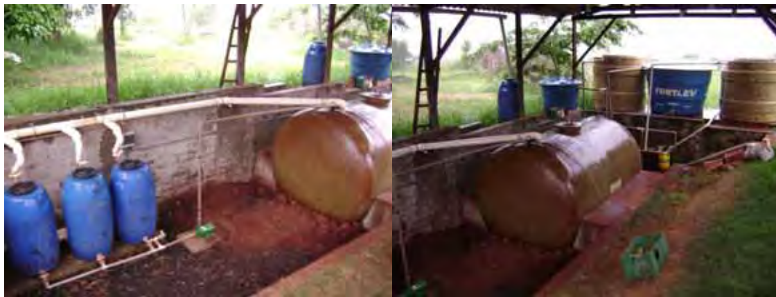
Figura 27. Estação experimental de coleta e tratamento simplificado de águas pluviais após as modificações mencionadas no presente trabalho
