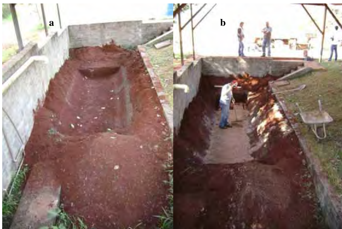
Figura 19: a) Vala escavada para berço do reservatório de 10m 3 , em 07/07/2011 b) cobertura da vala com areia, em 08/07/2011
