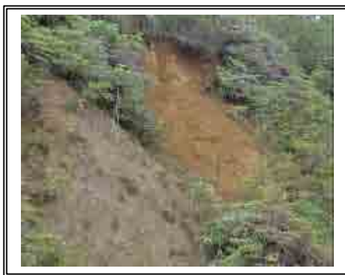
Figura III – Detalhe de um dos deslizamentos localizados na área.
