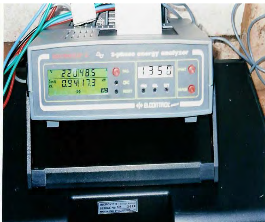
Figura 9. Medidor de Energia
