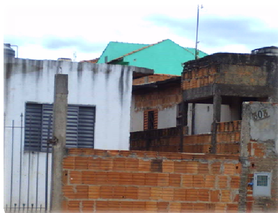
Foto 5. Imóvel sem acabamento
