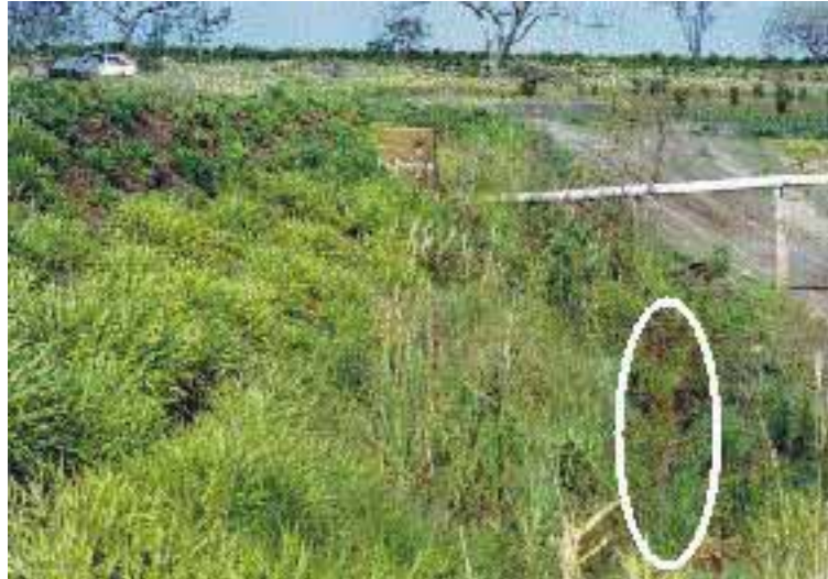
Figura 10 – Notar no detalhe excessivo fluxo de água e falta de dreno no “pé” de jusante da barragem. A água deste reservatório é utilizada para a irrigação de cultura de laranja. Córrego Salvador, a oeste da cidade de Monte Alegre de Minas (25/09/1999).
