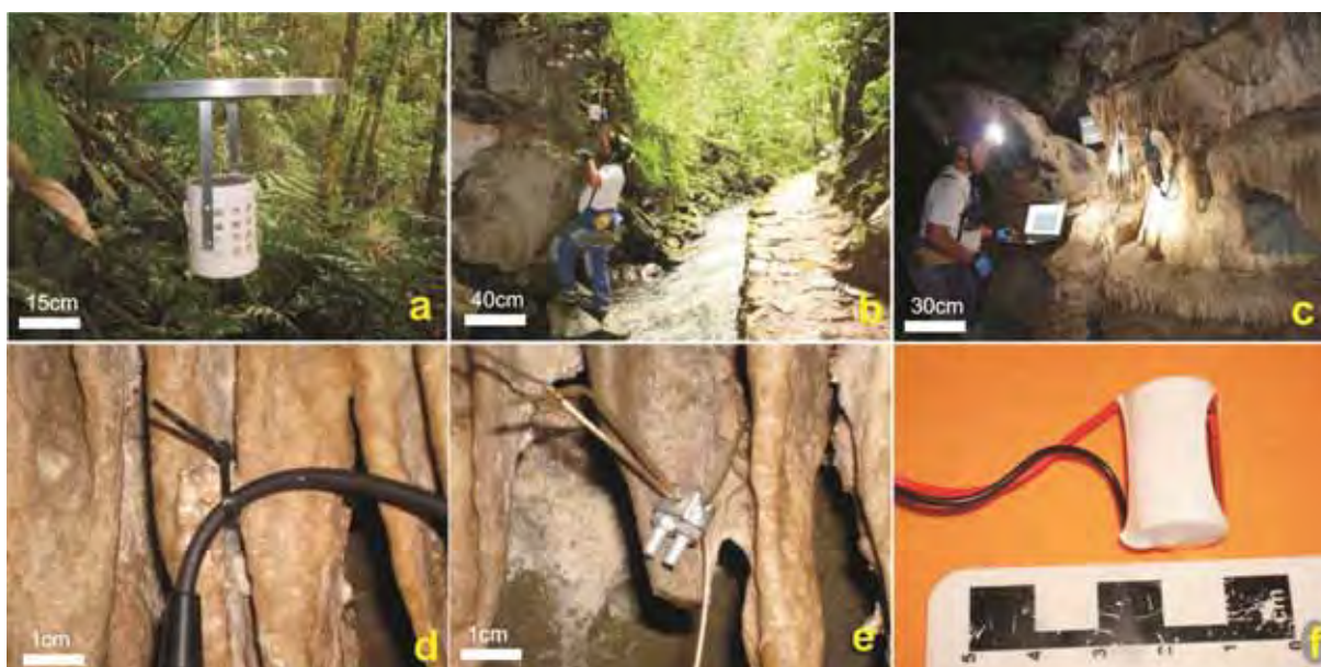
Figura 6.3 – a) Abrigo de chuva para os termohigrômetros externos; b) Ponto de instalação na ressurgência do rio Roncador; c) Laptop , usado para descarga de dados in situ e observação em gráfico dos resultados obtidos; d e e) Lacres plásticos, arames encapados e presilhas metálicas, utilizados para a fixação dos instrumentos e cabos em campo; f) Baterias ½ AA de 9V, utilizadas na maioria dos instrumentos da pesquisa.
