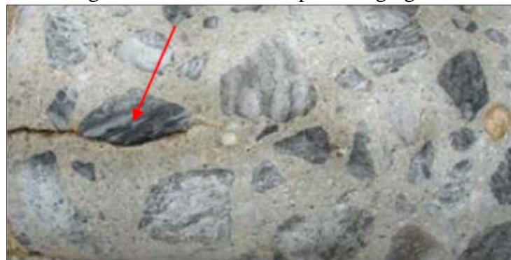
Figura 36- Fissuras entre pasta e agregado.
