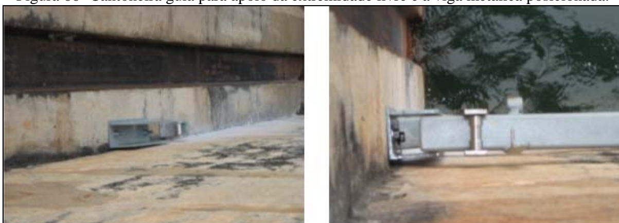
Figura 66- Cantoneira guia para apoio da extremidade livre e a viga metálica posicionada.
