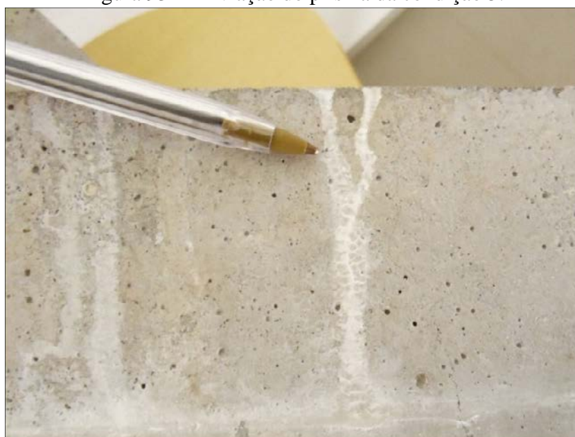
Figura 93- Lixiviação do prisma da condição 5.
