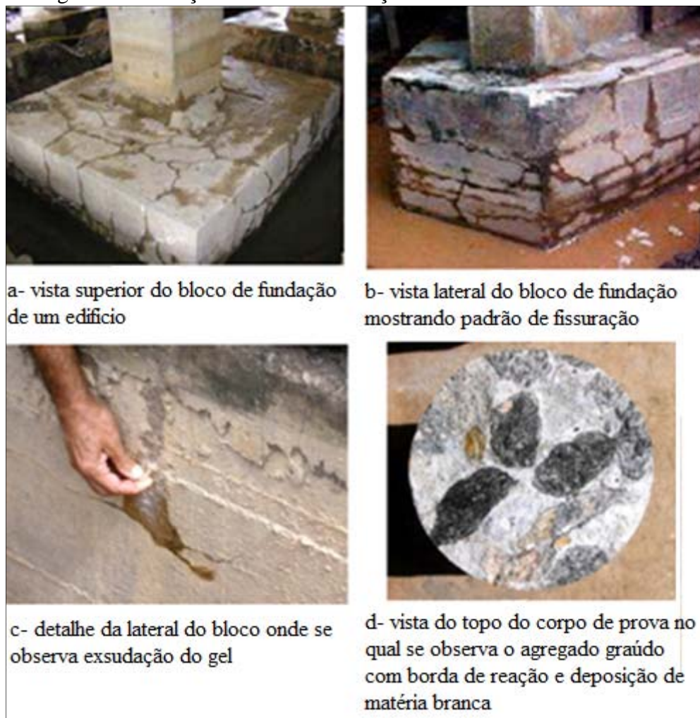
Figura 2- Presença da RAA em fundações de edifícios em Recife / PE.
