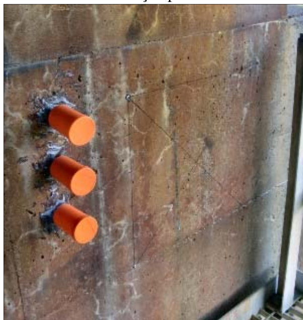
Figura 25- Painel de instrumentação para monitoramento da estrutura.
