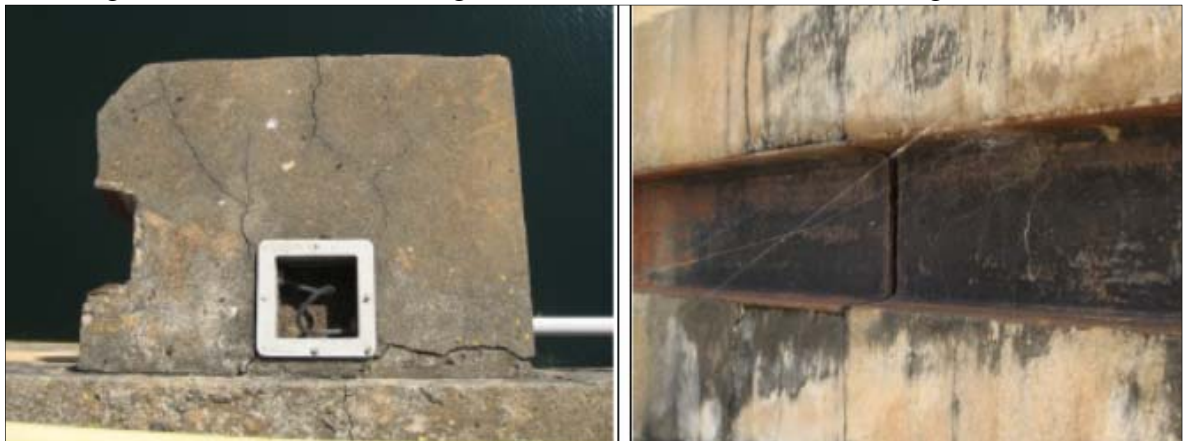
Figura 33- Fissuras no muro-guia e o deslocamento diferencial da guia metálica.
