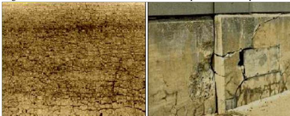
Figura 3- Pavimento de concreto e estrutura de ponte afetados pela RAA.
