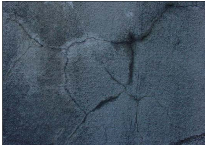
Figura 16- Fissuras típicas da RAA.
