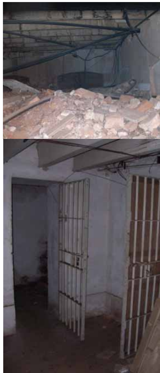
Foto 82: Presença de entulho no subsolo.
