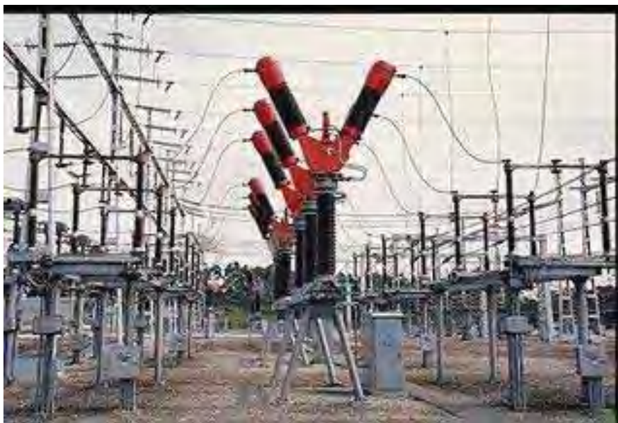
Figura 6: Disjuntor isolado a gás SF 6
