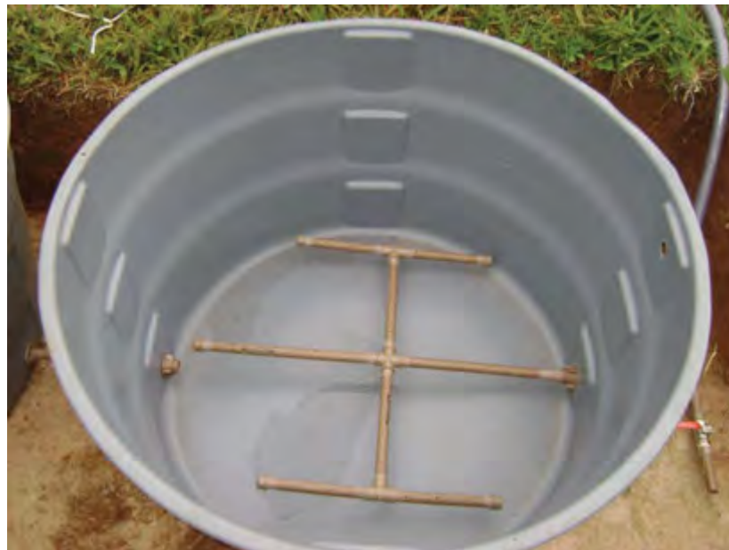
Figura 2. Tubulação interna das caixas.
