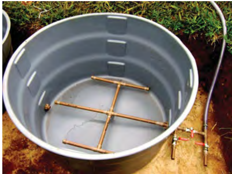
Figura 4. Tubulação dentro da caixa e válvulas de controle de vazão.
