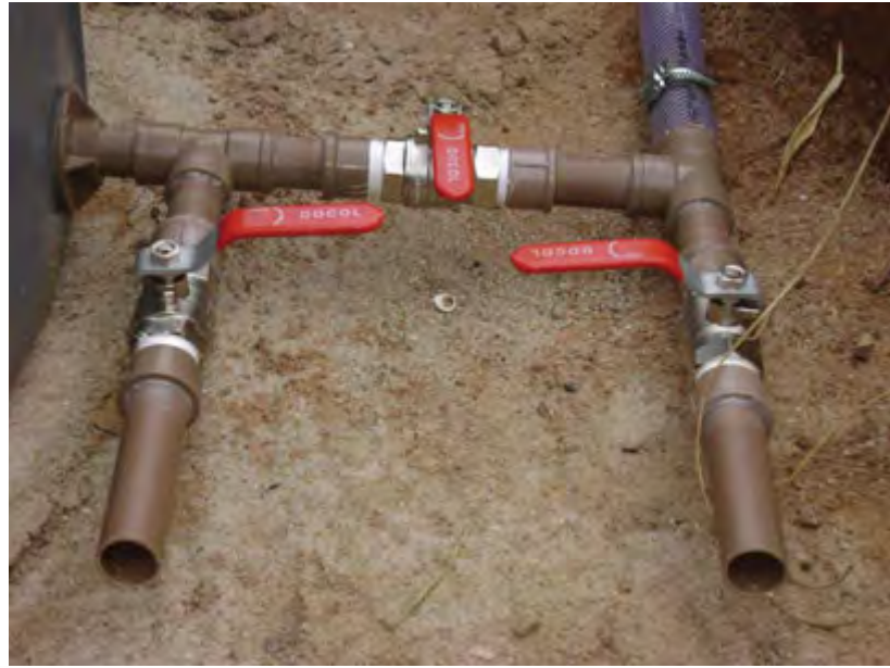
Figura 3. Válvulas de controle de vazão.
