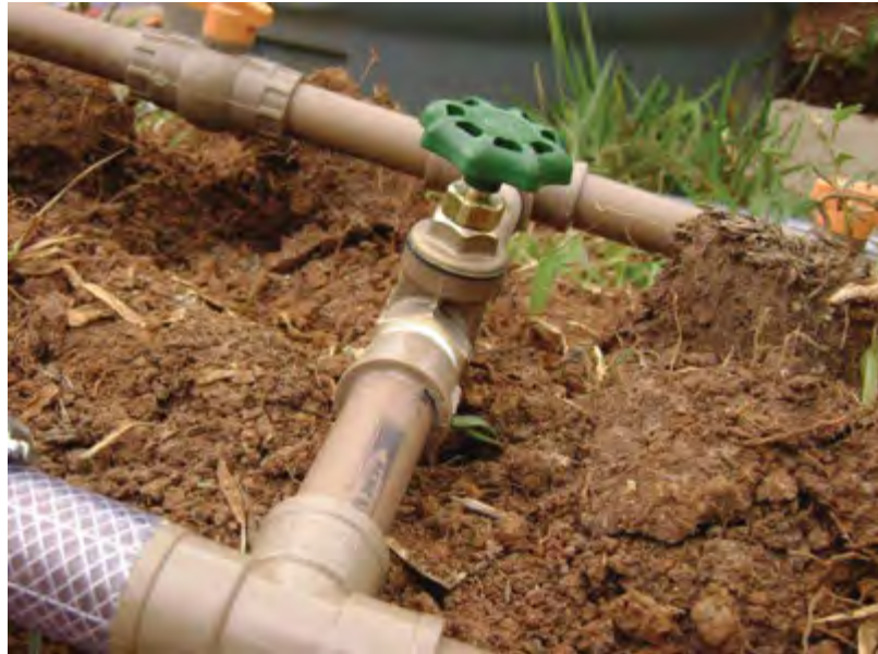
Figura 5. Registro de controle de vazão.
