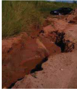
Foto 43: Erosão próxima a margem da represa Fonte: CASTILHO ET AL, 2006
