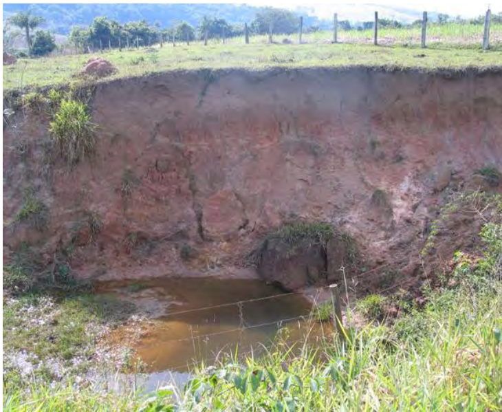
Figura 34 - Voçoroca em estágio avançado cortando a estrada vicinal.
