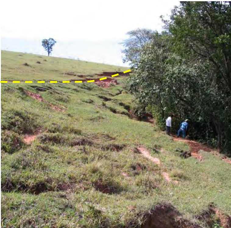
Figura 31 - Vista a montante de ravina de grandes proporções na Unidade 3 – Depósitos Coluvionares Cenozóicos. O traçado pontilhado corresponde ao curso da estrada vicinal.
