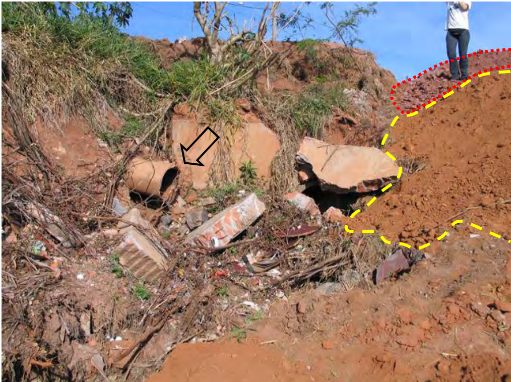
Figura 27 - Vista a montante de processo erosivo da área de estudo (Unidade 3 – Depósitos coluvionares cenozóicos) originado do descarte de água pluvial do sistema de drenagem de um loteamento em Ipeúna-SP. A seta indica a localização da galeria. A linha pontilhada vermelha corresponde ao solo natural, enquanto a amarela corresponde ao solo utilizado para o aterramento da erosão.
