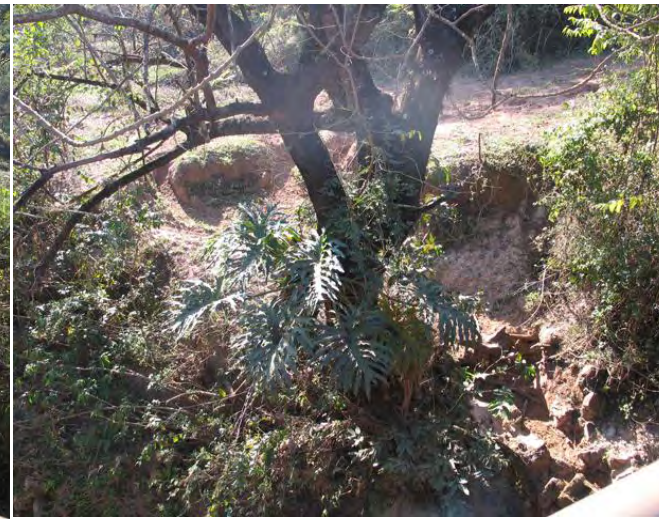
Figura 29 - – Solapamento de margem fluvial do ribeirão João Pinto.
