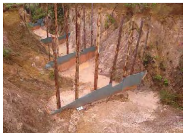
Figura 12 - Barramentos transversais instalados (FERREIRA et al, 2009).
