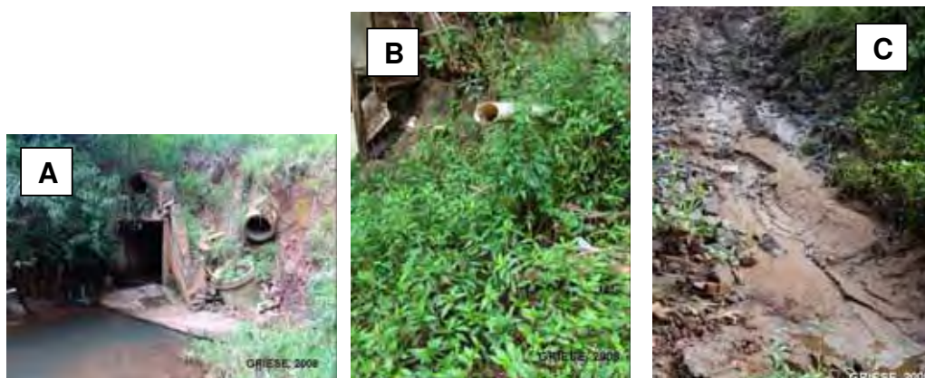
Figura 04: A – Estruturas de concreto danificadas no quarteirão 06, B – Cano de esgoto clandestino no quarteirão 07 e C – Assoreamento no leito do rio, quarteirão 05.
