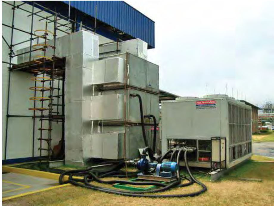
Fig. 2.4 – Equipamento de refrigeração industrial (POLISERVICE, 2011).
