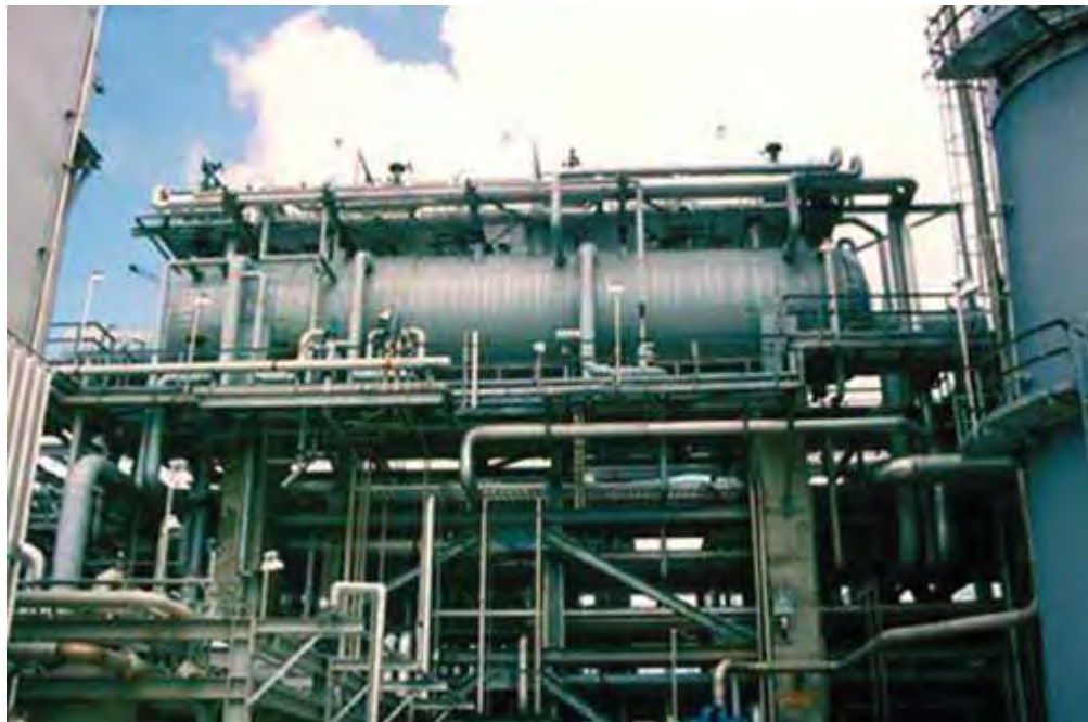
Fig. 2.2 – Sistema de refrigeração de grande porte (KBR, 2011).
