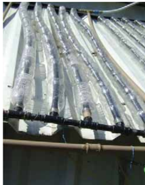
Figura 9 - Aquecedor com condutor de PVC
