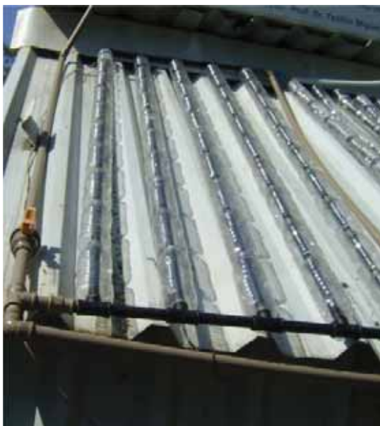
Figura 8 - Aquecedor com condutor de alumínio
