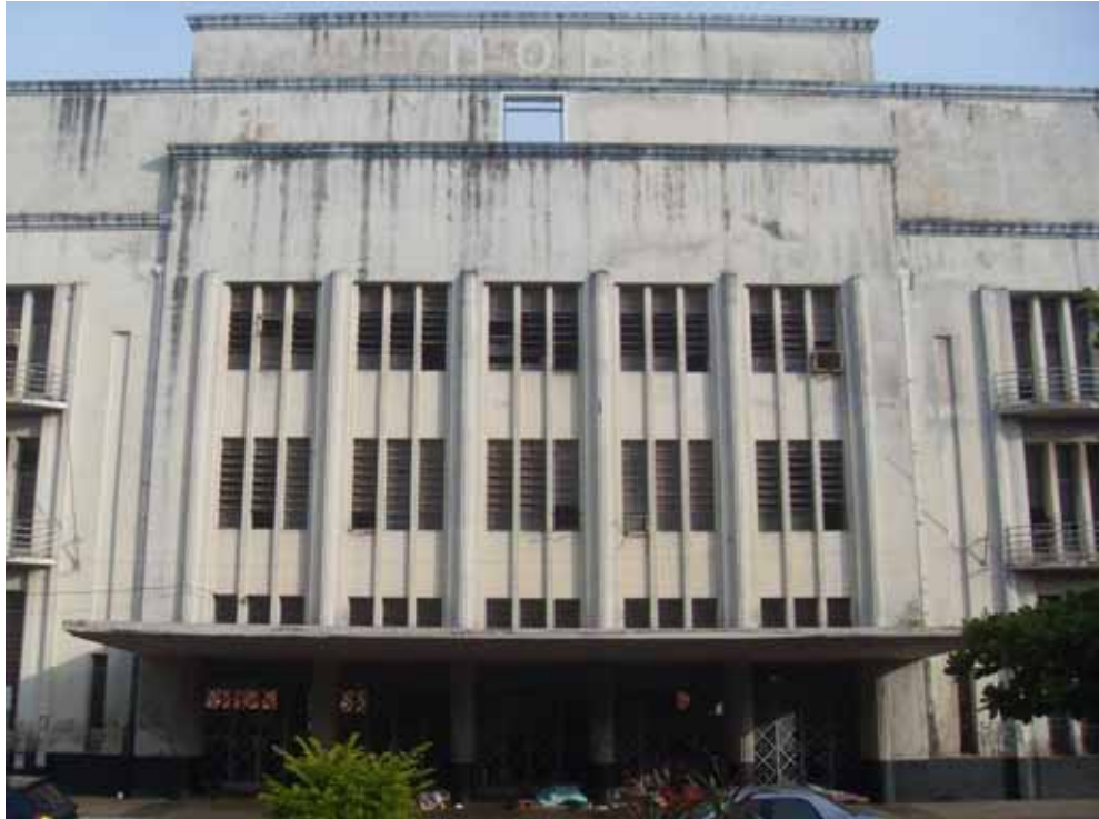
Estação da Noroeste. Detalhe para as janelas quebradas na parte superior do prédio (Bauru, maio de 2014). Crédito: Acervo do autor
