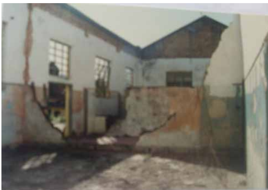
Fotos tiradas na ocasião da visita do memorialista Gabriel Ruiz Pelegrina e do ex-vereador José Eduardo Fernandes Ávila demonstram a situação do prédio da antiga tecelagem. Cobertura destelhada e muitas paredes de alvenaria demolidas (Bauru, janeiro de 1998). Crédito: Acervo do Museu Histórico de Bauru
