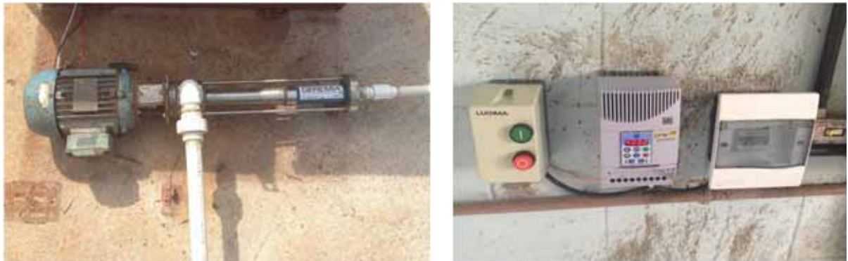
Figura 4- Bomba (esquerda) utilizada para lançar efluente na lagoa de lemnas e inversor de frequência (direita) ao meio.
