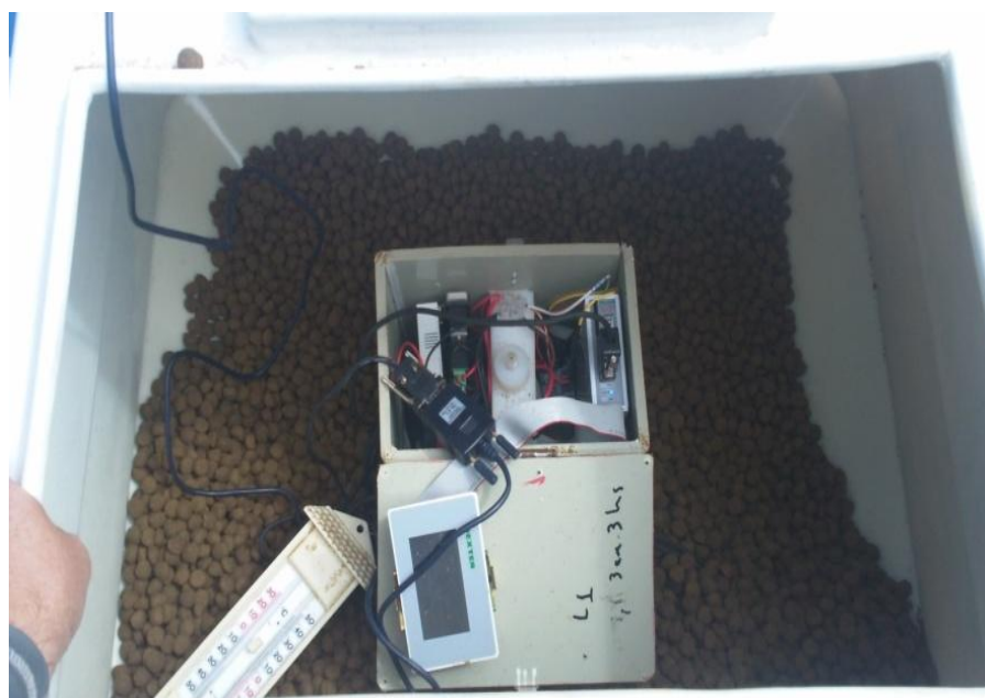
Figura 1. Componentes eletrônicos do sistema de alimentação automático, instalados dentro do reservatório de ração.
