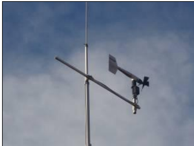
Figura 6. Anemômetro RM-YOUNG WIND MONITOR utilizado para determinação da velocidade e direção do vento no local.
