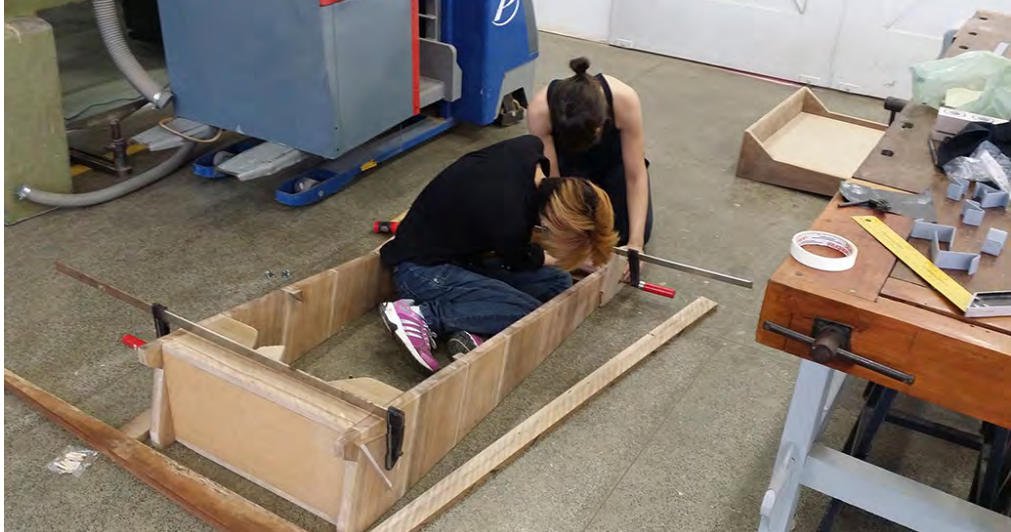
Fig.111: Pré-montagem para marcar o posicionamento dos furos do mancebo (Fonte: das Autoras)
