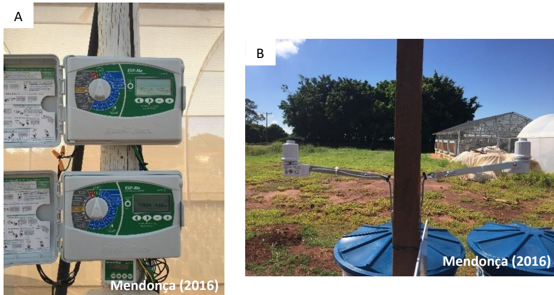
Figura 6 - Controladores (A) e sensores de chuva (B)
