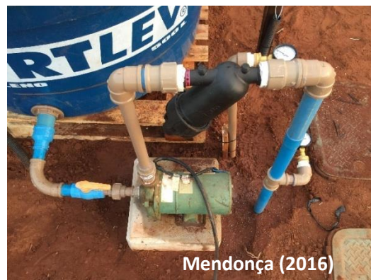
Figura 7 - Conjunto motobomba com filtro e manômetro
