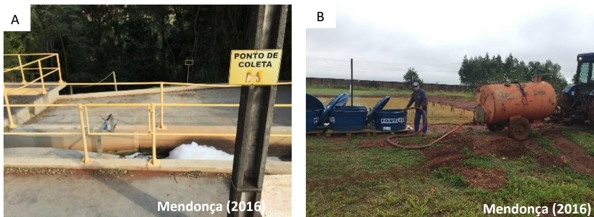
Figura 12 - Ponto de captação do efluente (A) e despejo nos reservatórios (B)
