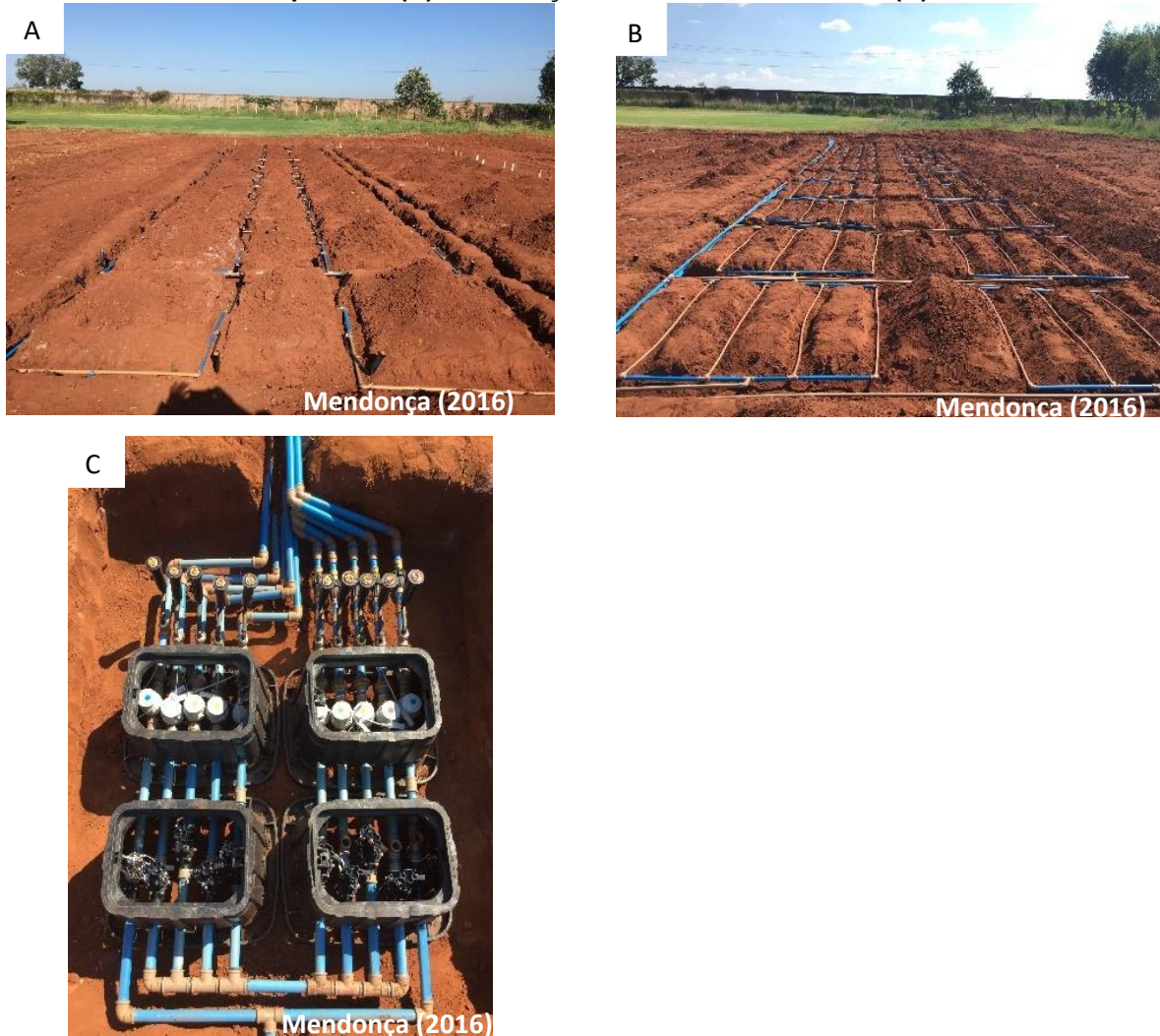
Figura 8 - Instalação do sistema de aspersão (A), instalação do sistema de gotejamento subsuperficial (B) e instalação das válvulas solenóide (C).
