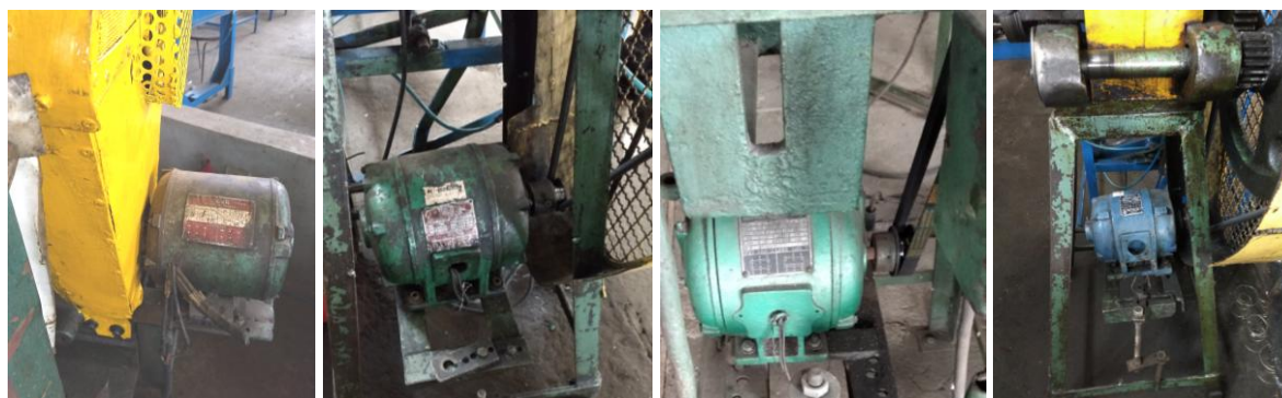
Figura 13 – Exemplos de motores elétricos instalados na empresa
