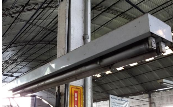
Figura 14 – Luminária tipo calha aberta instalada na empresa
