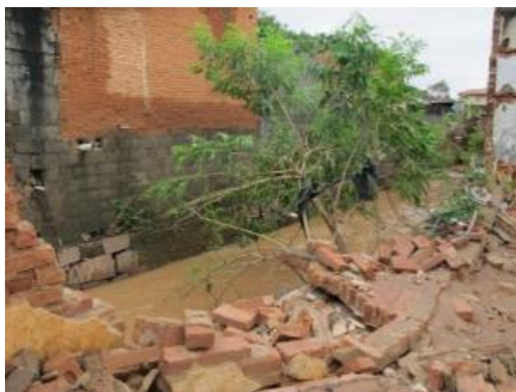
Figura 35. Muro dos fundos de centro automotivo foi derrubado pela água.
