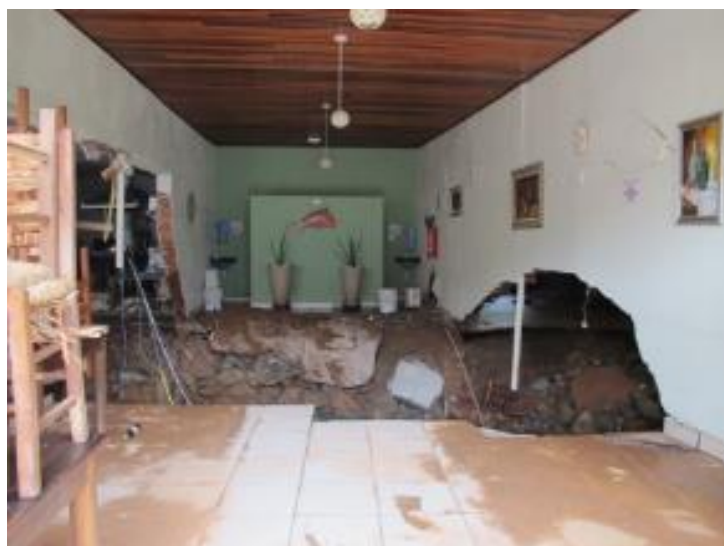
Figura 34. A força da enxurrada causou abertura de cratera em restaurante.
