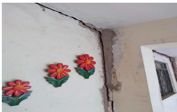
Figura 42. Recalque na Rua Anhumas, 150 no Bº Santa Rita (sala interna) (FOTO: Defesa Civil Piracicaba).
