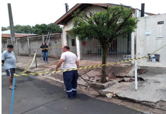
Figura 41. Recalque ocorrido na calçada da Rua Anhumas, 150 no Bº Perdizes (FOTO: Defesa Civil Piracicaba)
