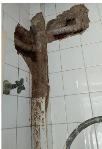
Figura 63 – Tubulação de PVC original com vazamento no Casemiro de Abreu
