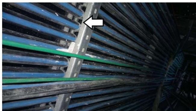
Figura 80 – Shaft de elétrica e passagem de cabos em seu interior
