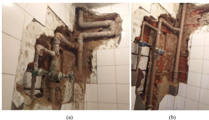
Figura 64 – Tubulações de água de PVC: (a) originais; (b) trocadas durante o conserto
