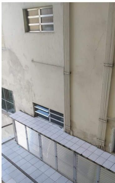
Figura 85 – Abrigo dos medidores de gás encanado
