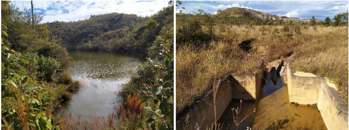
Figura 9 - Represa que antecede o canal de desvio (esquerda) e sistema de drenagem pluvial do BF-04 (direita).
