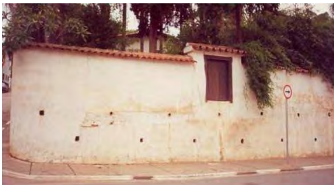
Figura 354. Último trecho do antigo muro de taipa remanescente do Mosteiro Beneditino de Santana de Parnaíba-SP. Este importante testemunho do início da arte brasileira foi impiedosamente demolido em 2008. Foto Rafael Schunk (2003).
