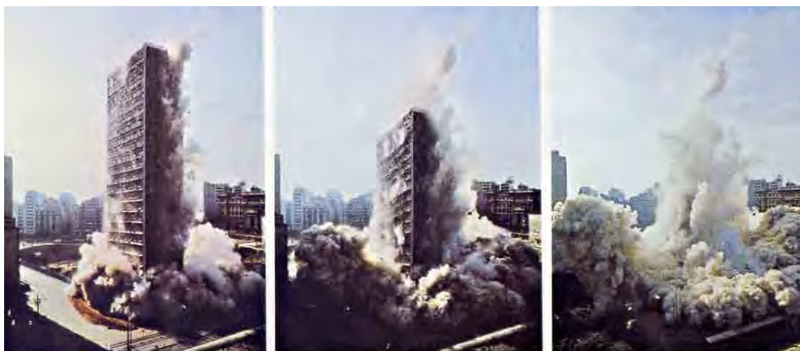
Em novembro de 1975, a implosão demoliu os 30 andares do edifício Mendes Caldeira em 8 segundos, abrindo espaço para a nova praça.
