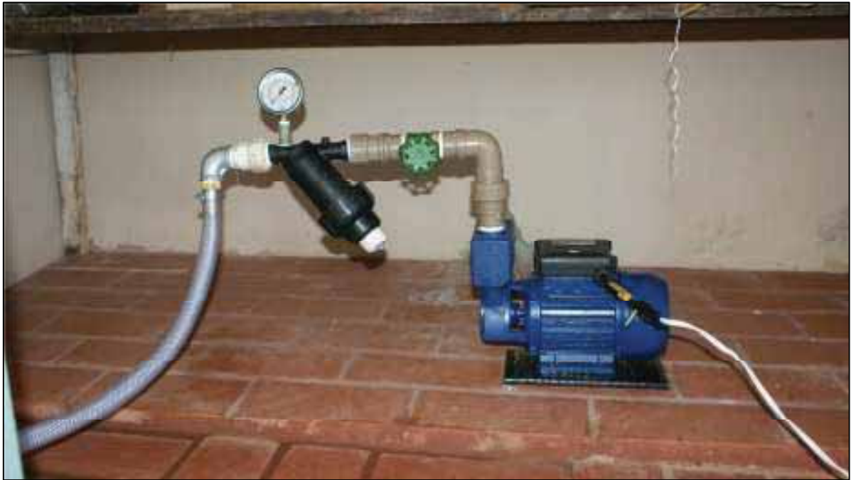
Figura 3. Instalação para pressurização do sistema.
