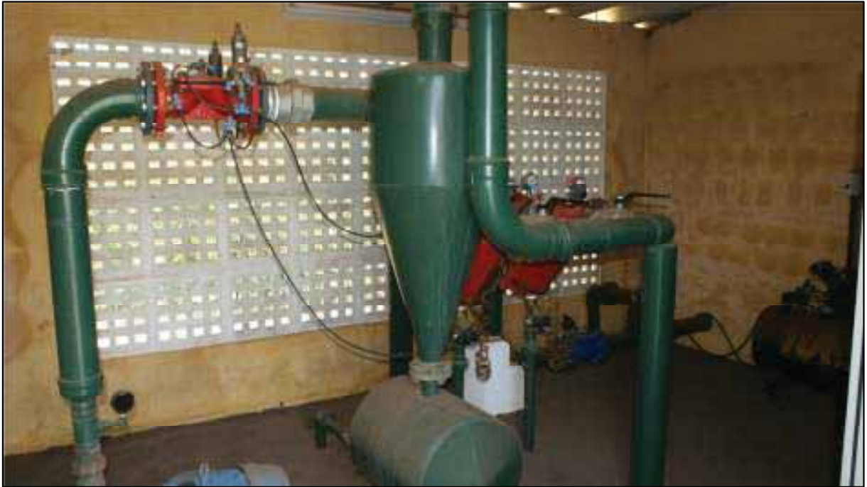
Figura 10. Hidrociclone e filtros de telas automatizados.
