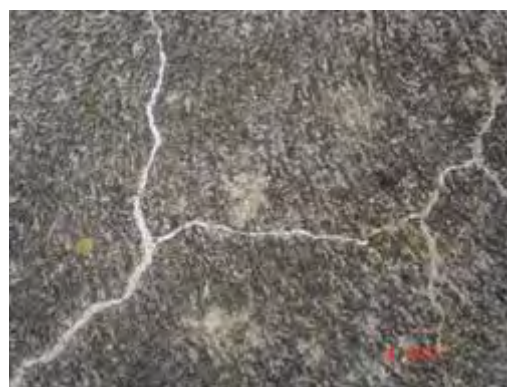
Detalhe da fissura preenchida com material branco 1
