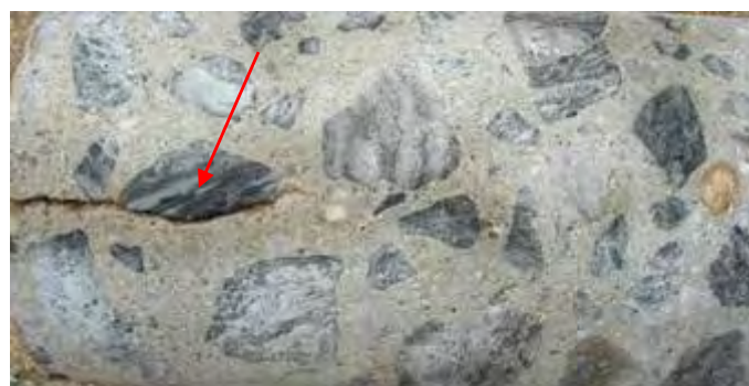
Fissura contornando o agregado
