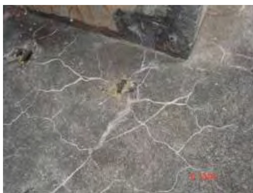
Fissuração tipo mapa na laje da Tomada d'água
