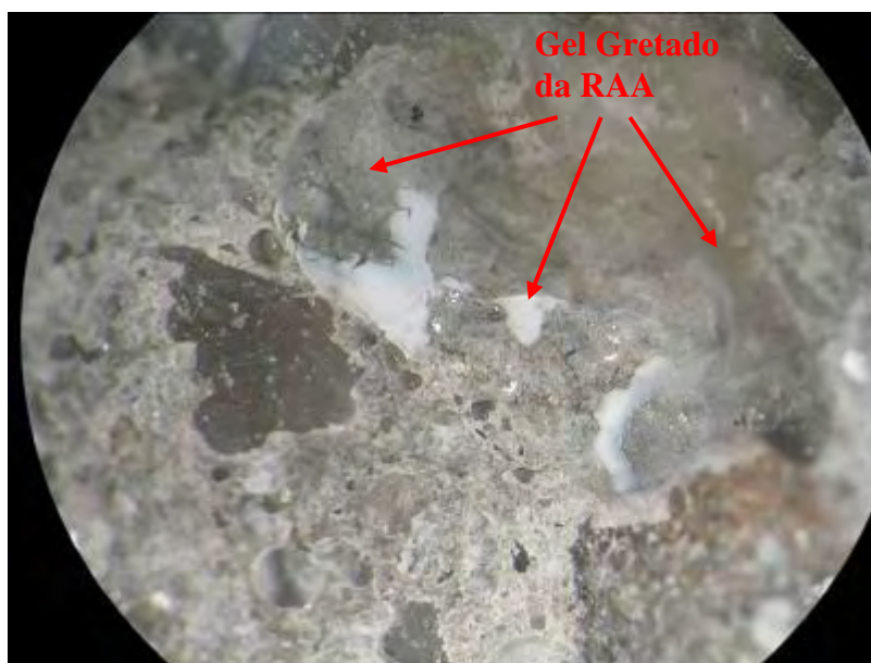
Figura 88 – Aspecto geral do concreto – Amostra: ERC – 60. Observa-se material branco depositado na superfície de descolamento do agregado graúdo da argamassa
