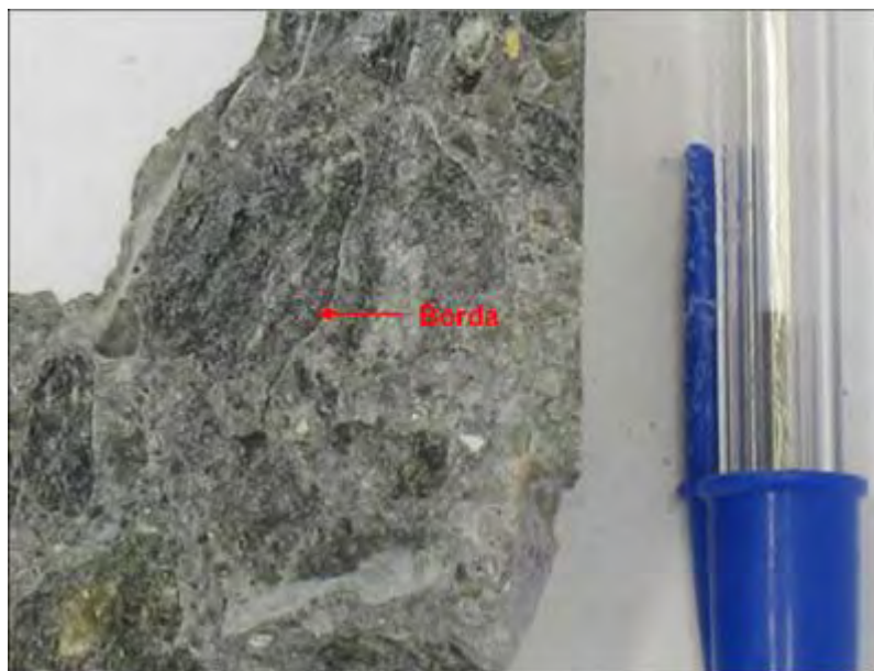
Figura 86 – Aspecto geral do concreto – Amostra: ERC – 38. Observa-se bordas de reação álcali-agregado (RAA) envolvendo o agregado graúdo
