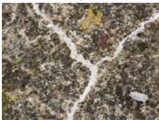
Detalhe do preenchimento da fissura com material branco exsudado
