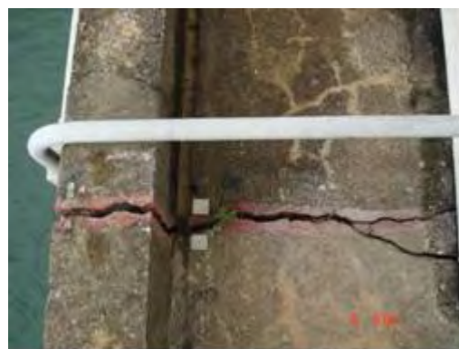
Fissuras na laje da TA alcançando 10 mm.
