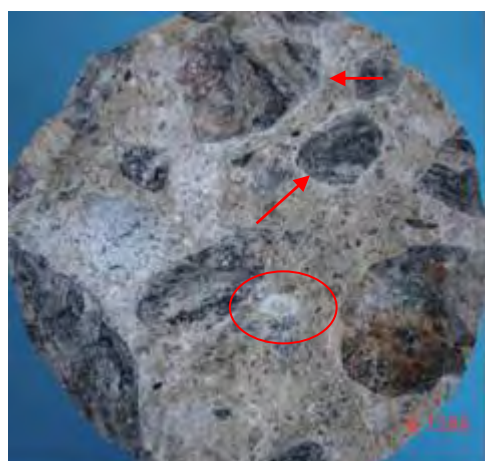
Borda preenchida com gel contornando o agregado (seta). Material branco com aspecto porcelânico (círculo) próximo ao agregado – Pilar da ponte da TA
