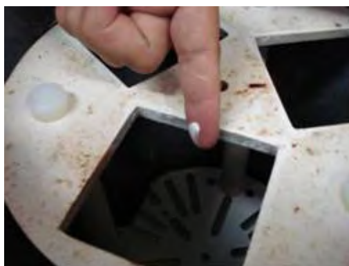
Figura 79 – Produtos carbonatados aderidos nas paredes do suporte dos prismas
