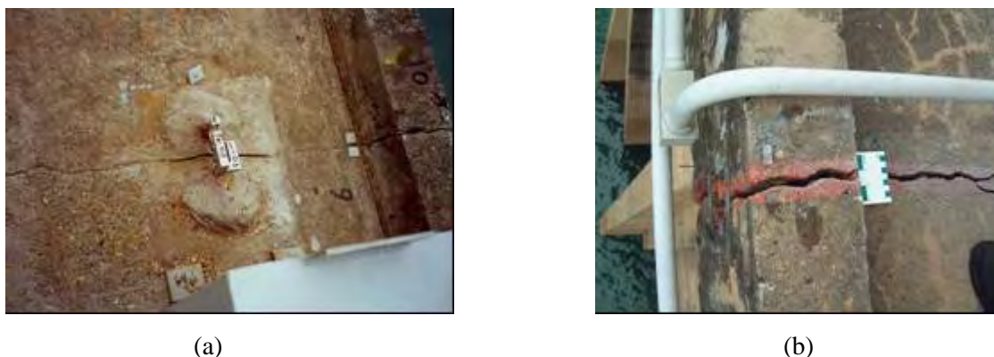
Figura 25 – (a) Detalhe do MT – 03; (b) Detalhe da fissura na TA e da placa de vidro
