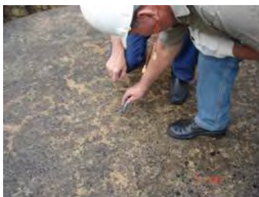
Marcação do local de extração do concreto – face superior do pilar a jusante da casa de força.
