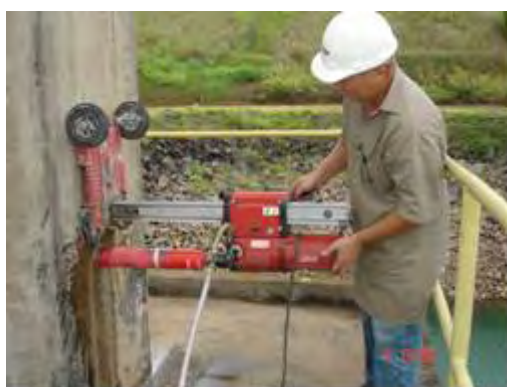
Instalação do equipamento de extração no pilar do pórtico de carga da Tomada d'água
