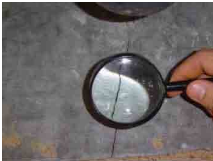
Figura 81: Última fissura observada (1mm) em uma das placas de CAD
