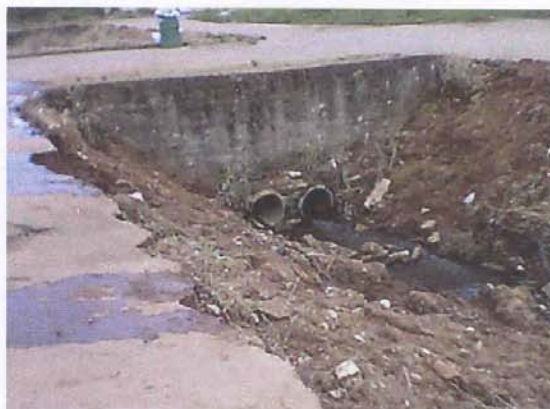
Foto 13- Foto tirada no dia da atividade de campo com vista para o Córrego das Almas, na Avenida Irmã Tosta. Observa-se a falta de infraestrutura local: ausência de contenção do talude, de condutores para água pluvial e asfaltamento inacabado. Ao fundo nota-se um latão para coleta de lixo, recipiente único e em local desapropriado.
