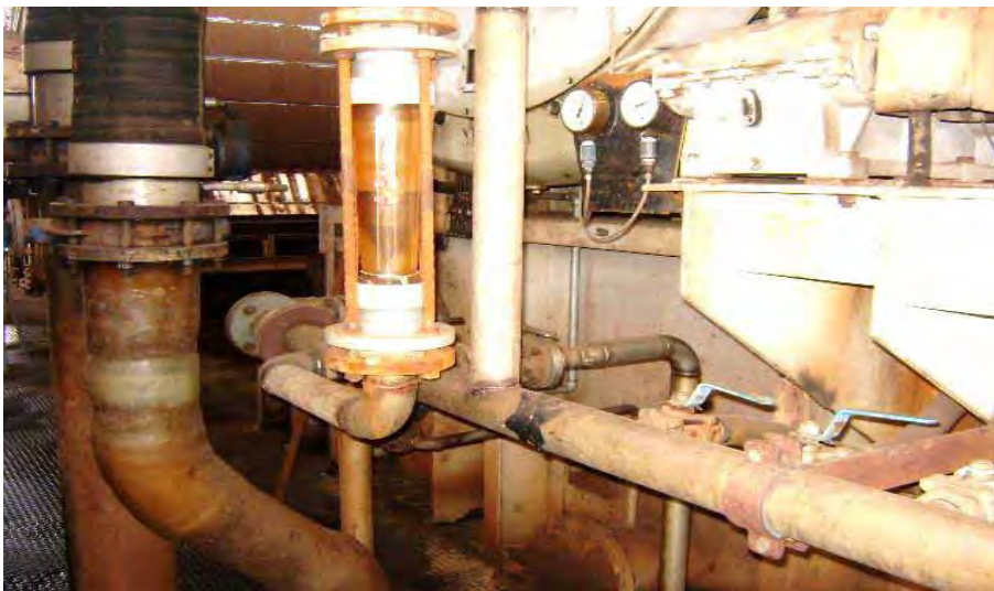
Figura 24 - Fotografia do medidor vazão tipo rotâmetro utilizado no experimento Fonte: usina (2008).
