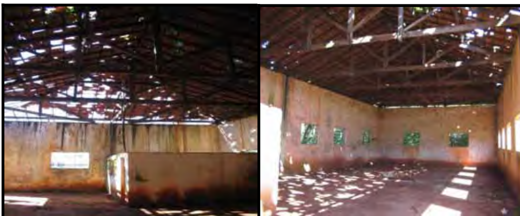
Figura 10: Vista da parte interna da construção com total aparência de abandono.
