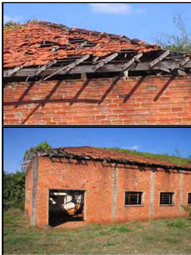
Figura 9: Observa-se com maior detalhamento a precariedade do telhado e da própria forma.
